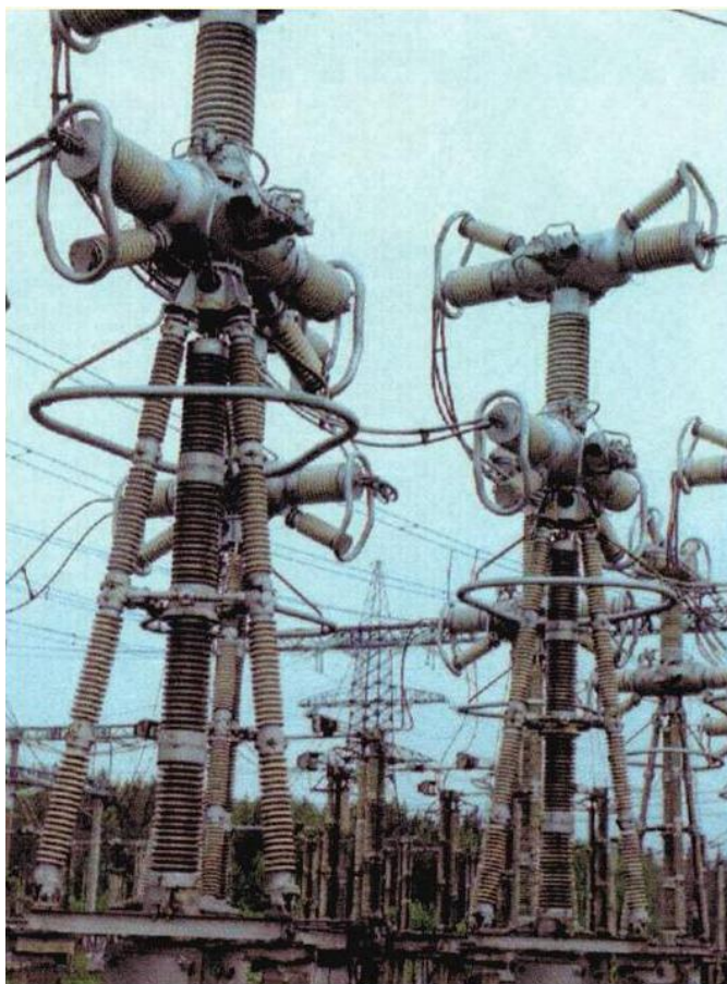
Рисунок 9.5. Воздушные выключатели на напряже- ние 330 кВ
