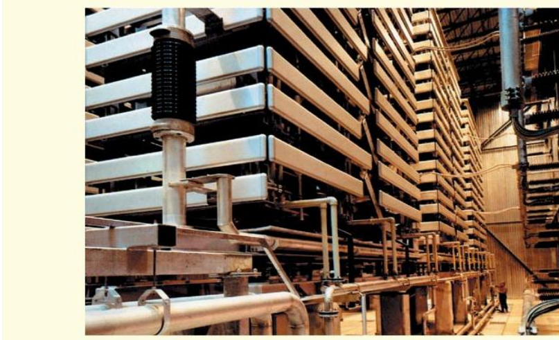
Рисунок 12.3. Внешний вид вентильного зала
