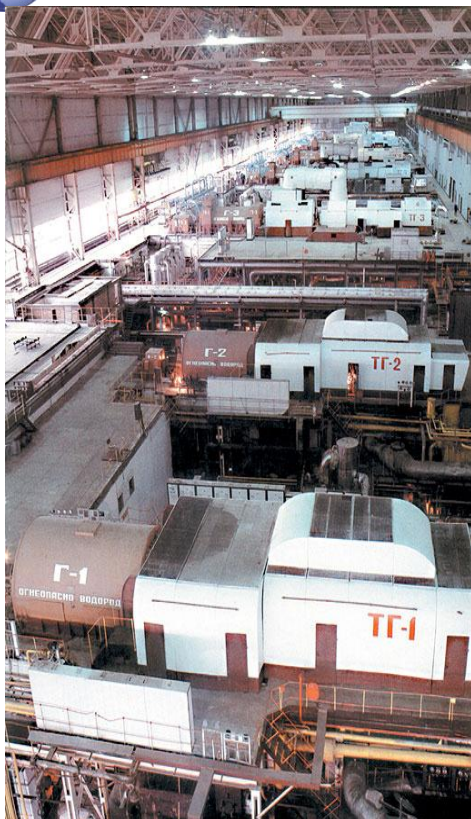
Рисунок 3.13 Общий вид машзала типичной ТЭС
