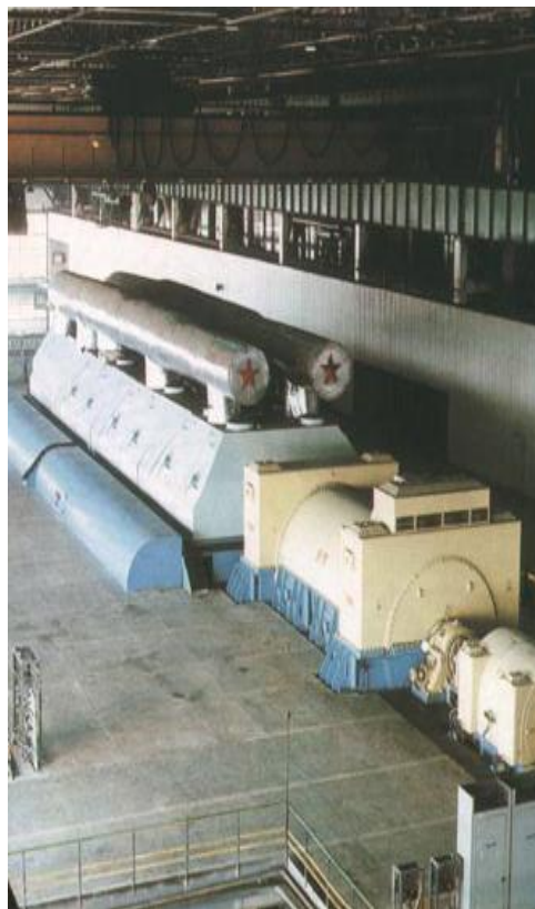
Рисунок 3.14. Общий вид турбоагрегата мощностью 800 МВт
