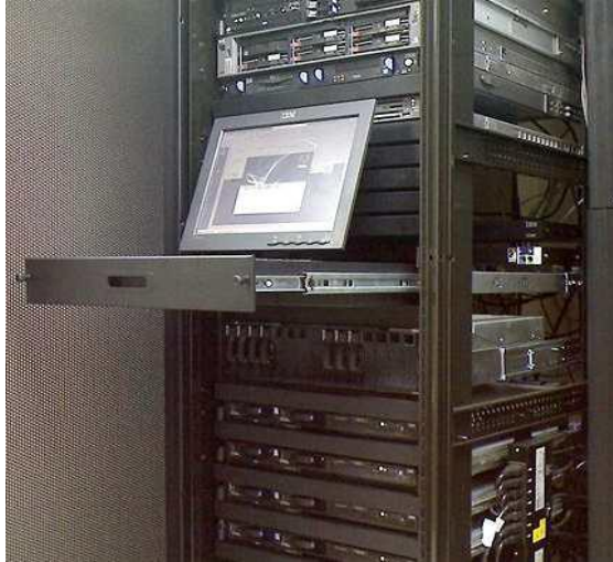
Рисунок – Серверный шкаф
