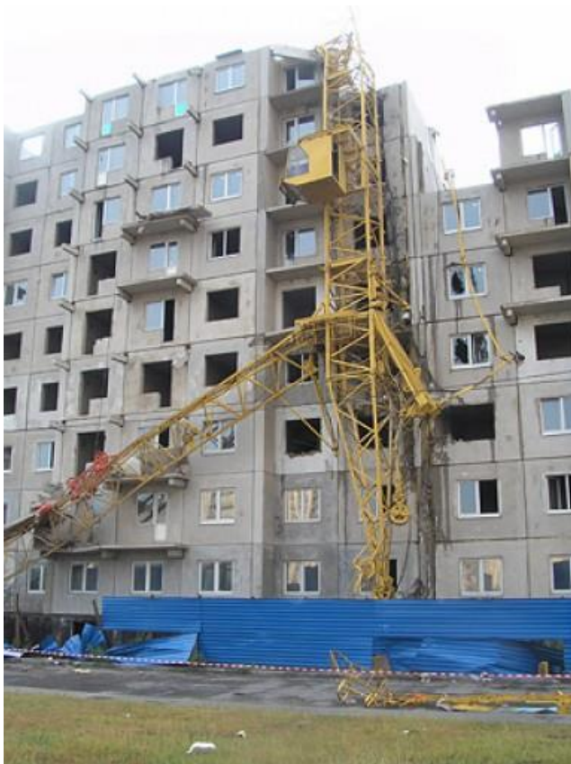
Рис.1.4.7. Авария башенного крана вследствие нарушения условий подъема грузов
