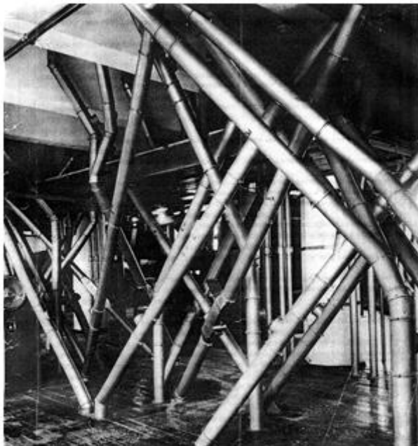
Рис.1.5.20. Общий вид систем трубопроводов мельницы (верхние этажи)
