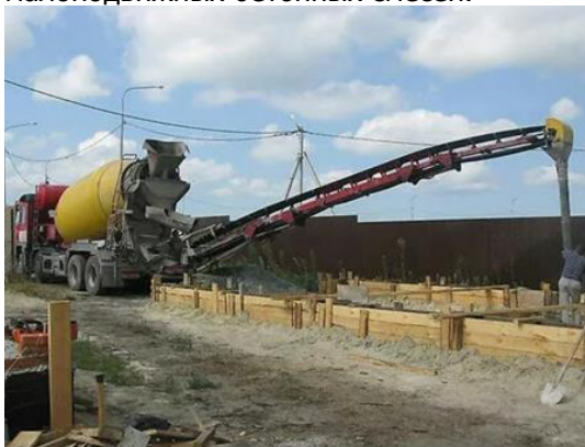
Рисунок 12 – Подача бетонной смеси в опалубку фундамента с помощью автобетоносмесителя, оснащенного ленточным конвейером
