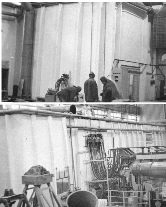
Рис. 6. Насосно-аккумуляторная станция и трансформаторная подстанция СИТО-2 завода Ростсельмаш
